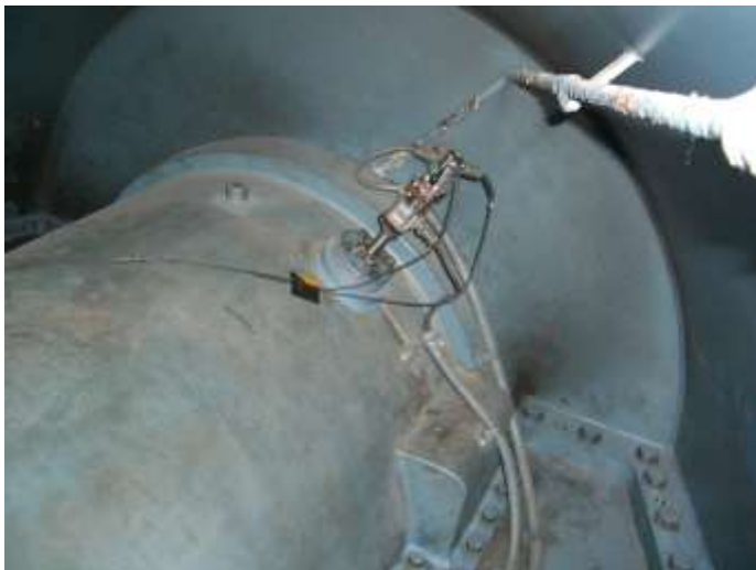
発電機軸受(振動、回転数を計測)
