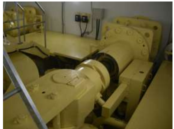
ガイドベーン (羽の角度により出力調整を行なう)
