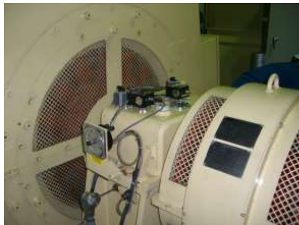
発電機軸受(振動、回転数を計測)
