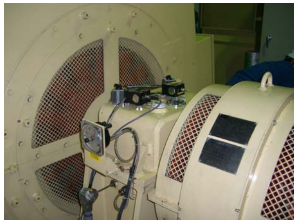
発電機軸受(振動、回転数を計測)
